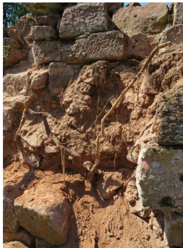
Exemple de racines encastrées dans la muraille
