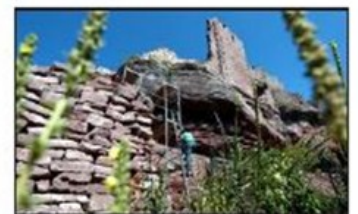
Des murs à consolider.
