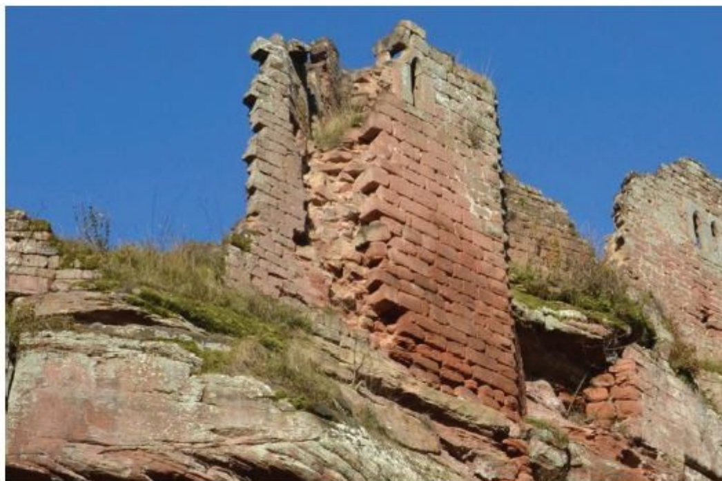
Le mur du logis seigneurial nécessite d'importants travaux. PHOTOS DNA
