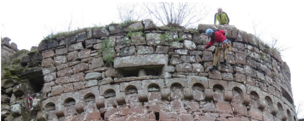
Débroussaillage de la grosse tour d'artillerie en rappel.
