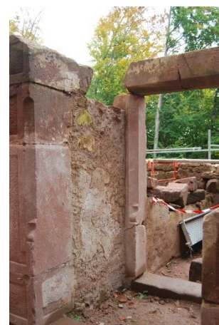
État dans lequel nous avons retrouvé le mur et les traces d'enduit d'origine.
