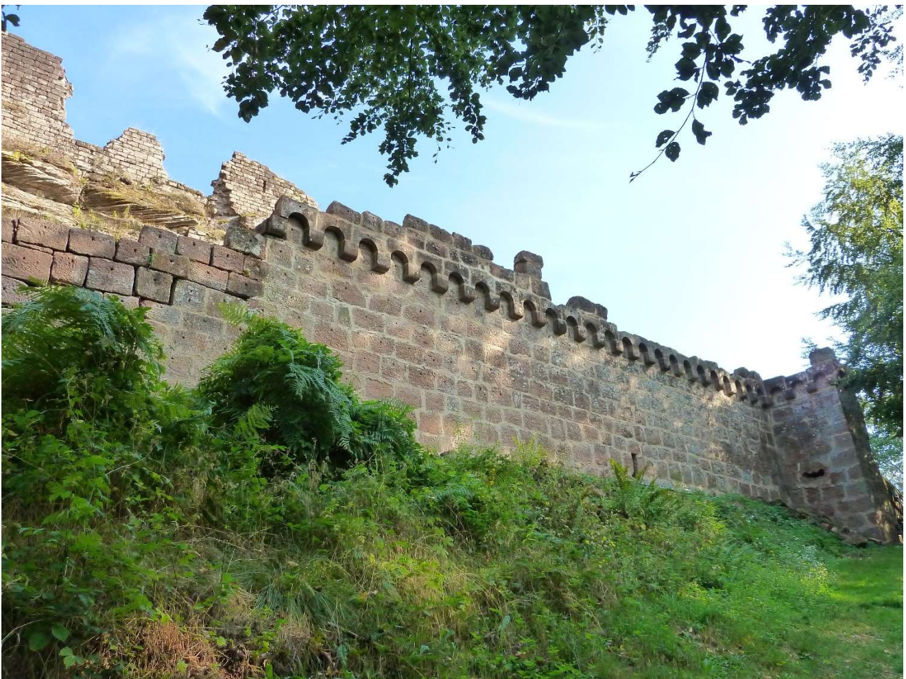
Vue sur la portion du rempart jointée cette année. Complètement restauré, il sera impressionnant. A gauche, une partie des blocs qu'il faudra déposer et remonter.
