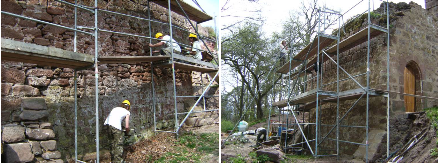
Jointoiment du parement extérieur du mur périphérique de la barbacane Sud-Est David Kontomichos, Thomas Becht et Jacques Bruderer
