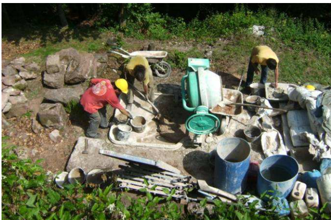
Zone de préparation du mortier pour la tour semi-circulaire, Marc, Jacques et Alain
