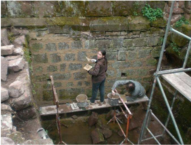
Delphine et Emmanuel en train de jointoyer la paroi Ouest du fossé.
