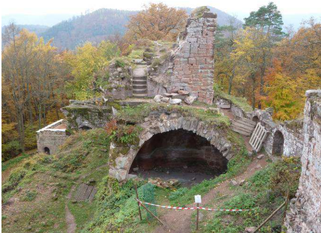
Accès au rocher Sud barré après l'effondrement du mur
