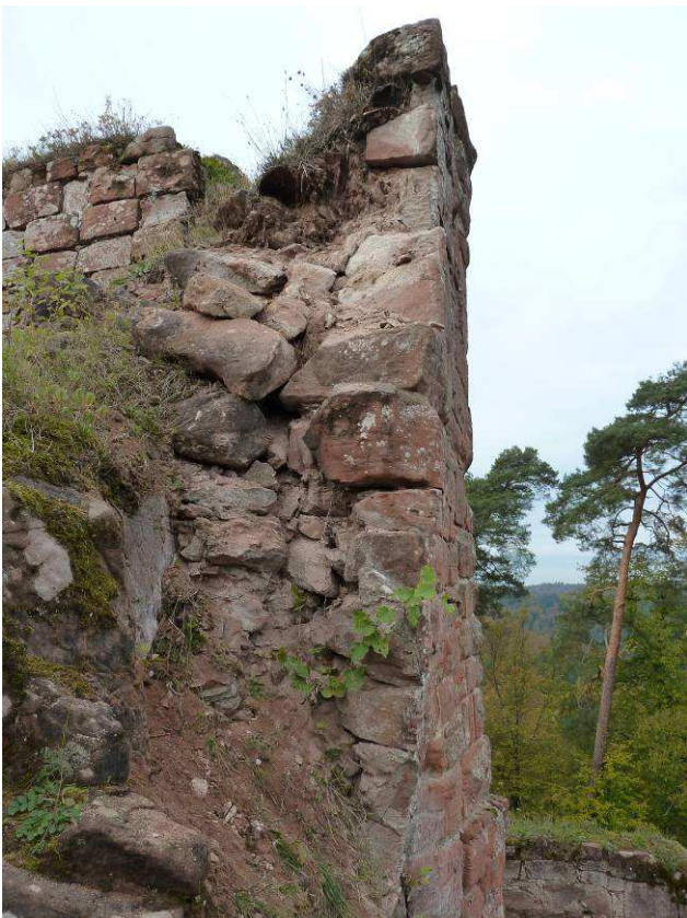
Mur Nord du rocher Sud après effondrement
