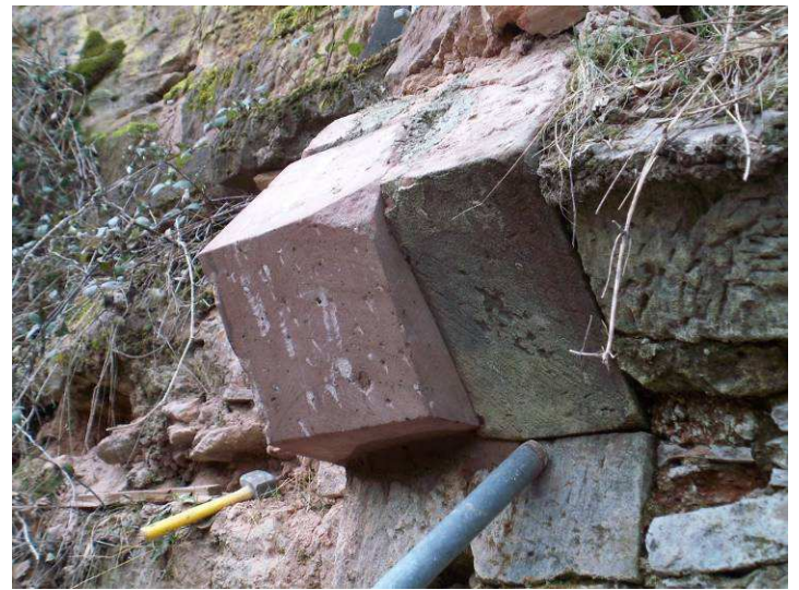
Empiècement en place, à retailer ensuite sur place pour donner la courbe
