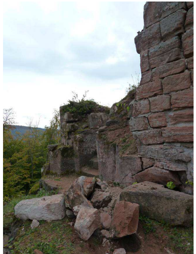
Mur Nord du rocher Sud après effondrement
