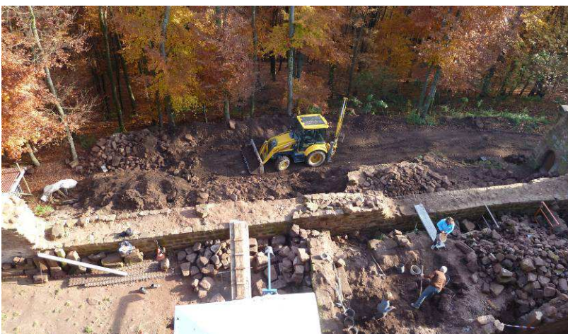
Vue de dessus de l'ensemble du rempart Est en cours de dégagement.
