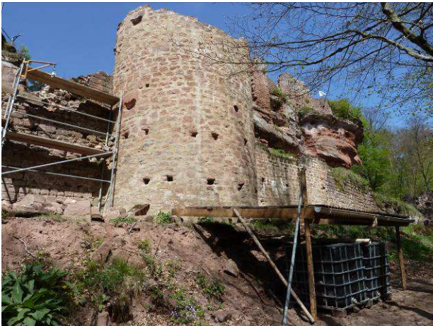
Récupérateur d'eau et la tour.
