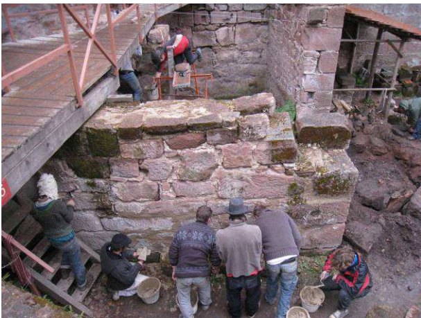
Jointoiment de la pile du pont-levis.
