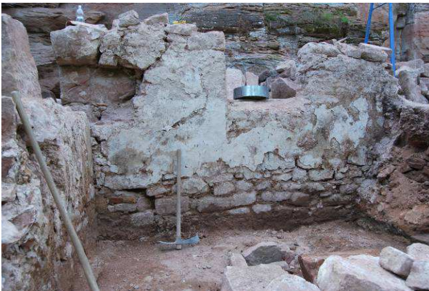
Enduit sur le mur de la deuxième pièce.
