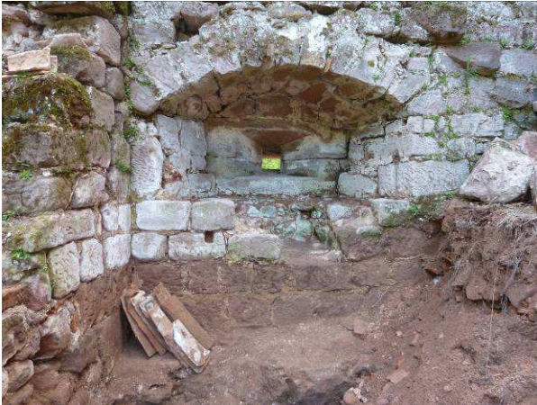
Niche avant consolidation
