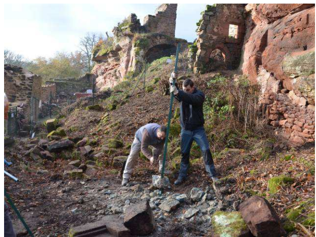
Destruction de la fondation du poteau du grillage.
