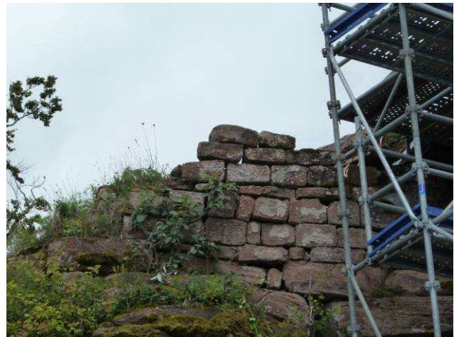
Etat du mur avant dépose, côté extérieur.
