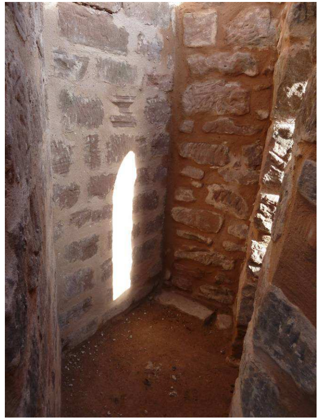
Intérieur du réduit une fois les travaux achevés avec la fente d'éclairage à droite.
