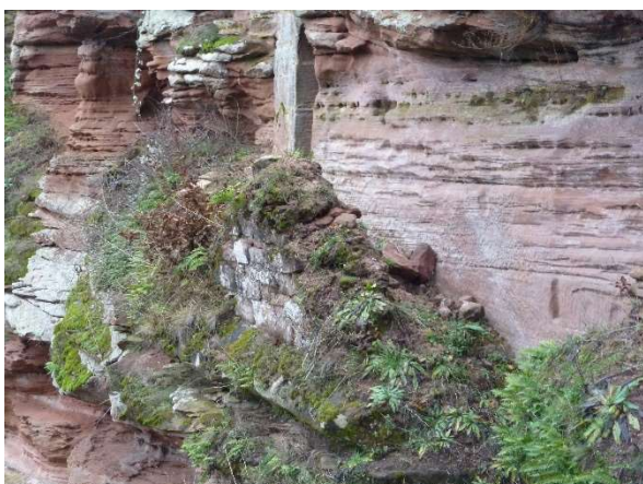
Eboulement des pierres sur le muret à mi-hauteur du rocher. Association Cun Ulmer Grün Rapport d'activités 2017
