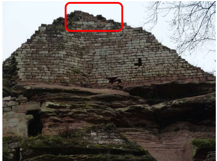
Mur après la chute des pierres constatée le 13-12-2017.
