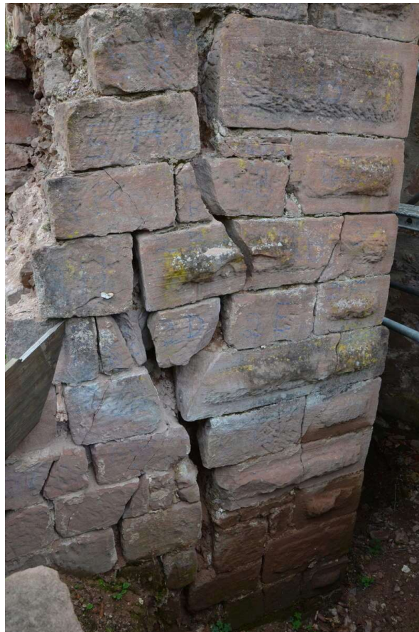
Fissure dans le mur d'angle à l'intérieur de la tour.
