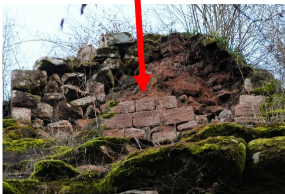
Mur après son effondrement en 2026.
