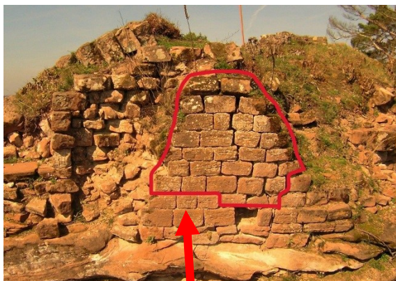
Le mur en 2017 avant son effondrement. (Photo Jean-Christophe Matz)
