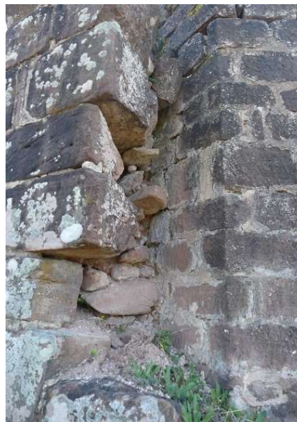
L'arrachement avant les travaux.
